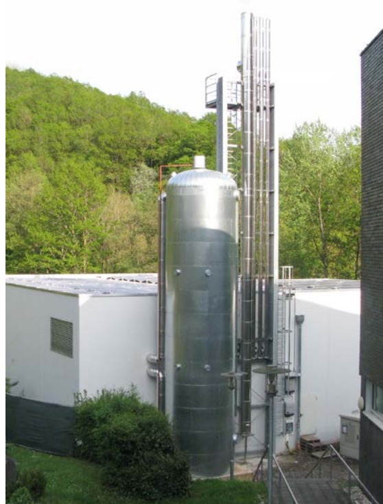
Fig. 06-8 Termo acumulador centralizado
