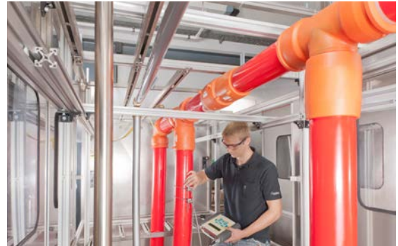
Fig. 06-21 Los tubos y la técnica de unión son controlados como un sistema único
