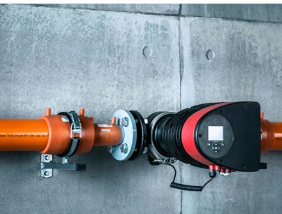
Fig. 05-1 Central de calefacción
