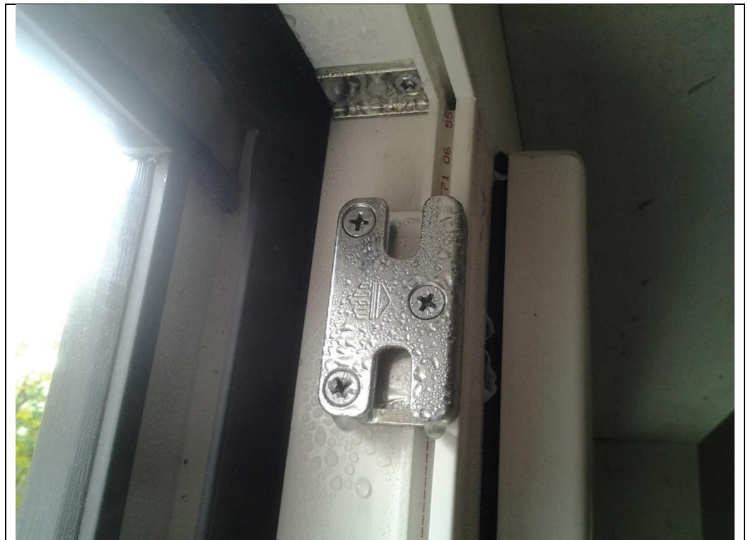
Foto Sieber: Kondensat im Fensterfalz aufgrund von einströmender Raumluft.
